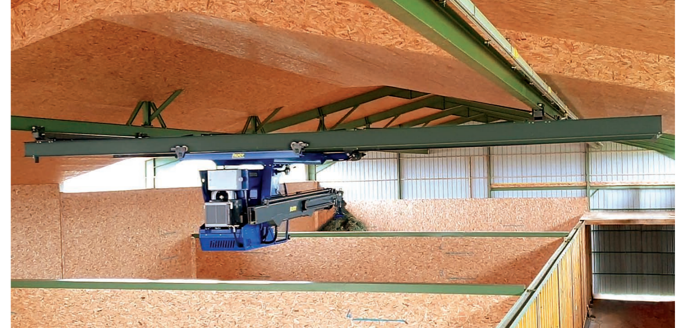
Un robuste pont roulant engendre moins d'oscillations et facilite le travail de la grue
