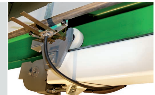
Alimentation électrique en gaine fermée
